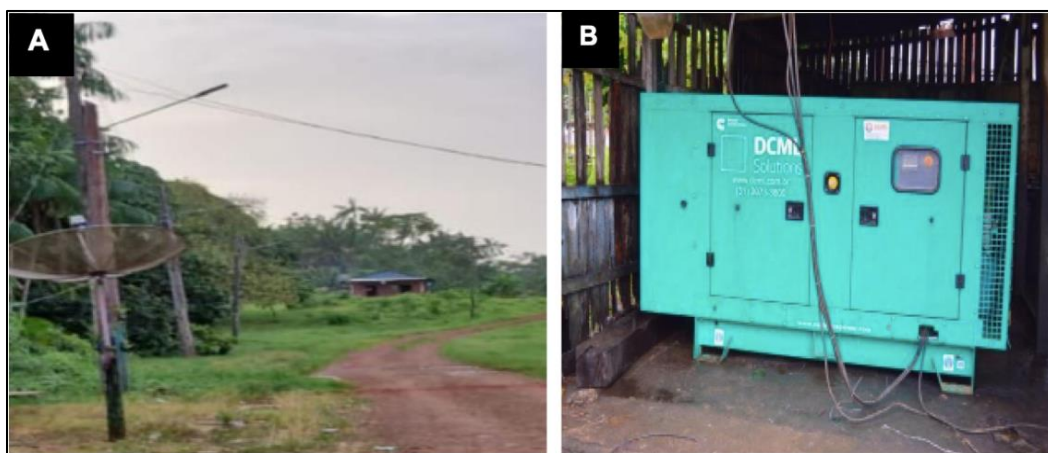
Figura 5 - Fotografias mostrando a presença de energia elétrica na Vila Velha do Cassiporé
