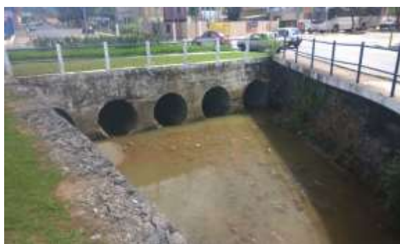
Figura 5- Retificação, mal dimensionamento de tubulações e alto grau de impermeabilização em setor da baixa bacia.
