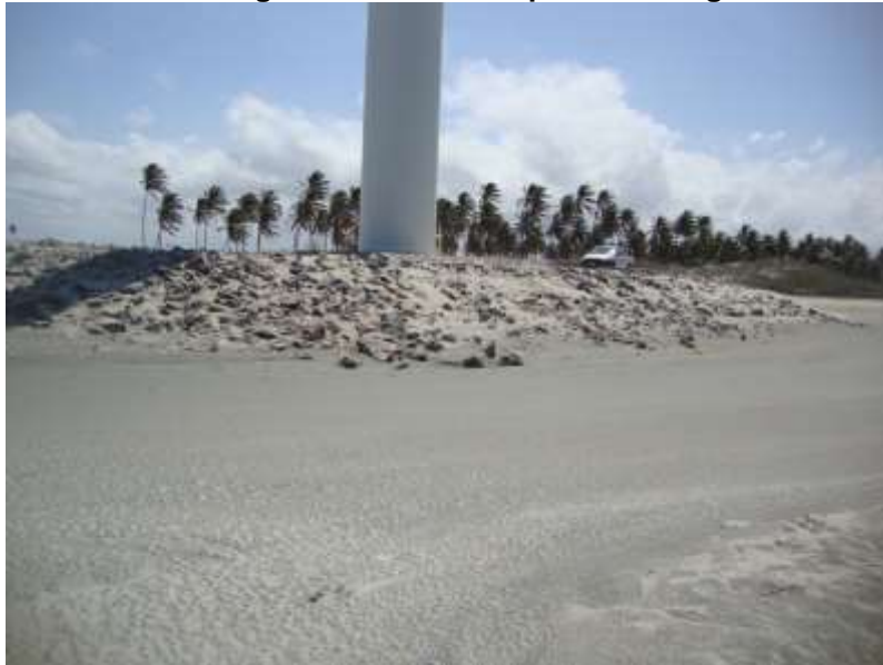
Figura 4 – Erosão na praia de Morgado
