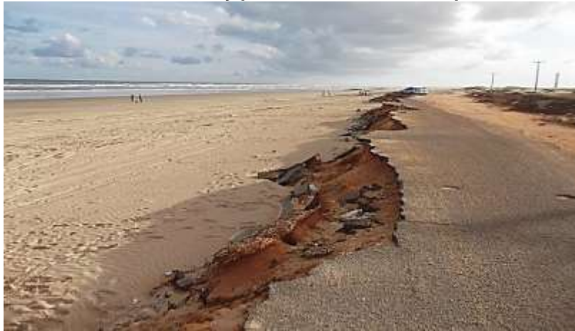
Figura 02: Rodovia José Sarney parcialmente destruída pela erosão costeira
