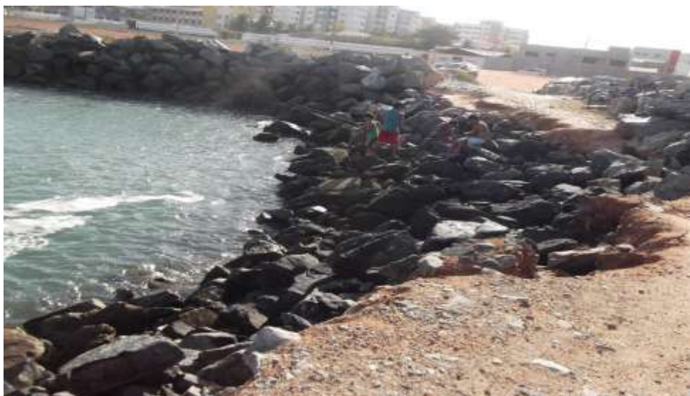
Figura 01: Erosão na margem direita do rio Sergipe no bairro Coroa do Meio.
