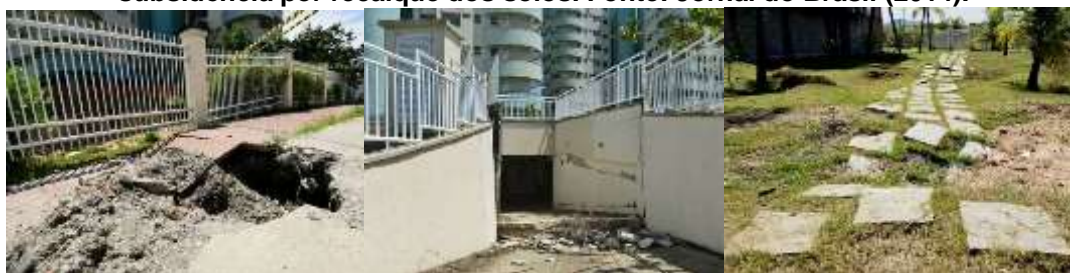
Figura 2 - Problemas geotécnicos e estruturais na Vila do Pan causados por processos de subsidência por recalque dos solos. Fonte: Jornal do Brasil (2014).
