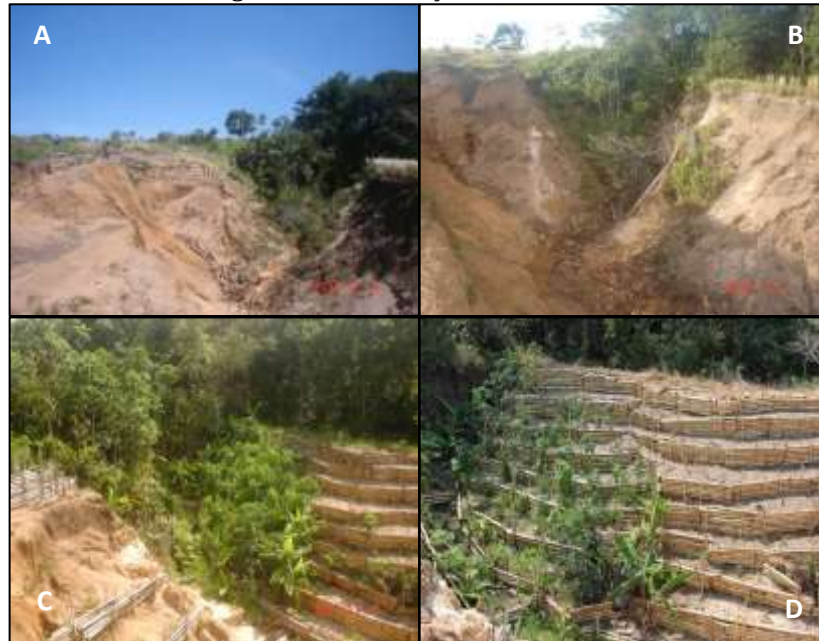
Figura 4 – A e B - Fotografias do leito principal da Voçoroca da Parede; C e D - atividades de corte/aterro. Bacia do Córrego Queixada, Voçoroca da Parede, Reserva do Cabaçal/MT.
