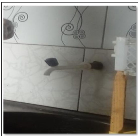
Figura 3: Torneira de uso residencial usada para coletar a amostra de água da rede de distribuição do poço tubular da Alegria.
